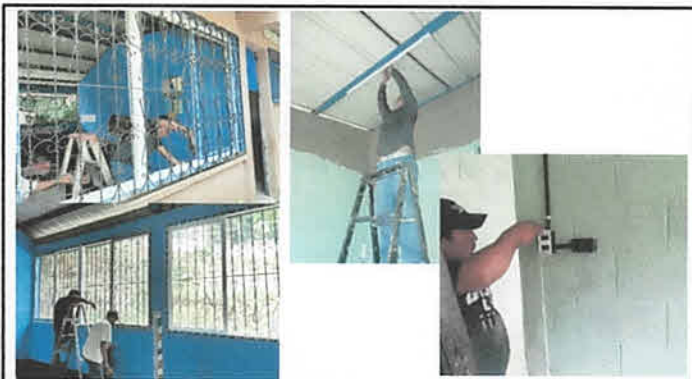
Foto 3: Instalación de ventanería de PVC e instalación de sistema eléctrico en Dirección
