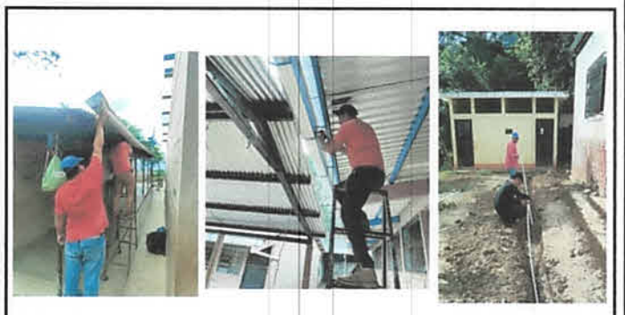
Foto 6: Desmontaje e Instalación de canales con pescantes de metal y bajadas pluviales. Además se trabajó en la conducción de agua potable hacia servicios sanitarios.
